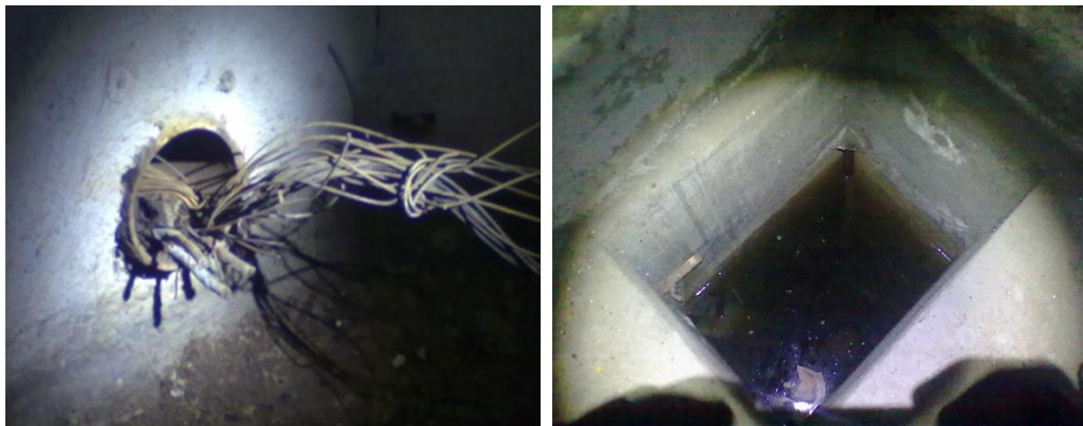
Obr. 19, 20: kabelový vstup v MO-S 10 (vlevo) a kabelová šachta v MO-S 9 (foto: Patrik Falhauer, 2012)
