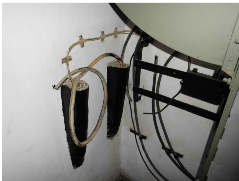
Obr. 21: vstupy kabelu v MO-S 5 (foto: Martin Hejda, 2013)
